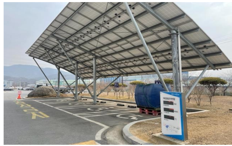
세종공장 태양광 발전설비 2014년 10월~
